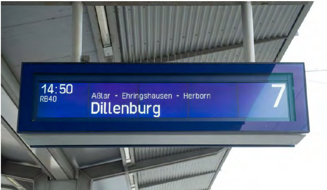
Abbildung 36: Digitale Fahrgastinformationsanlage (DFI) in Wetzlar (Foto: R. Städtler)
