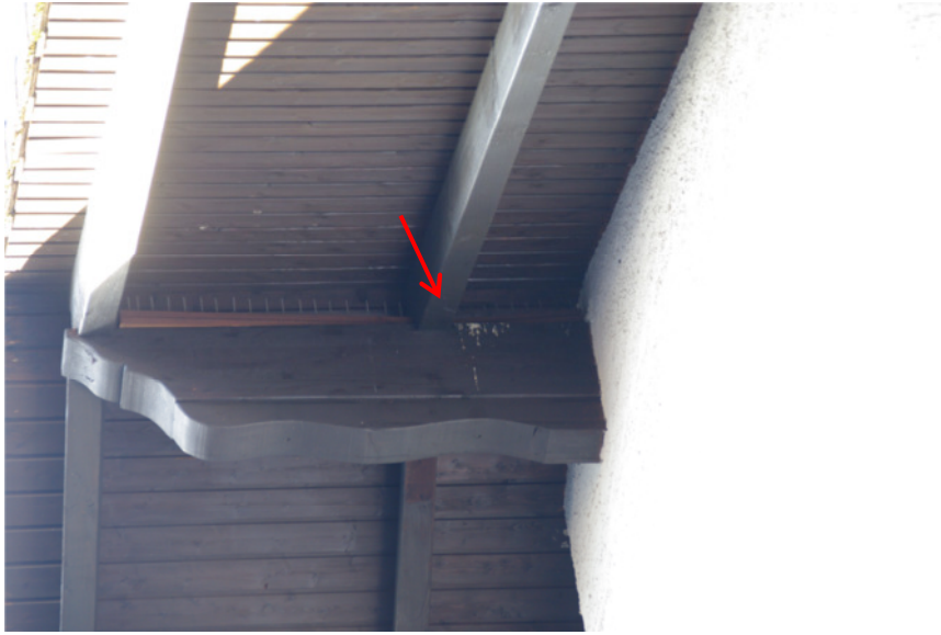
Kotspuren auf Balken trotz Taubenabwehrspikes
