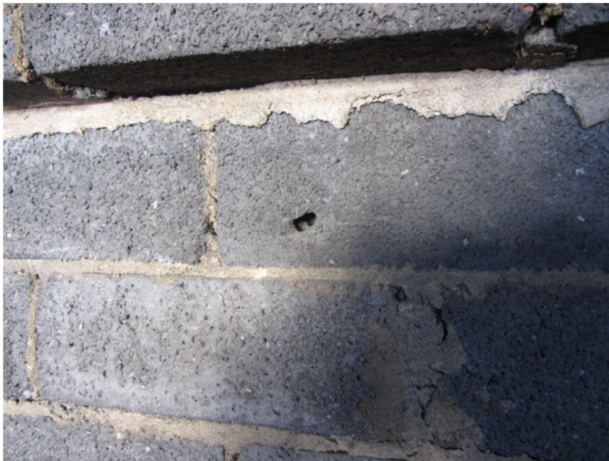
Loch in Mauersteinen, das einen Zugang zum Inneren des Hohlblocksteines ermöglicht
