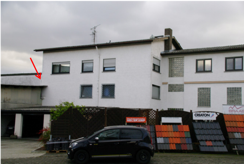
Wohngebäude von der Straßenseite. Schmale Spalten zwischen den Gebäudeteilen
