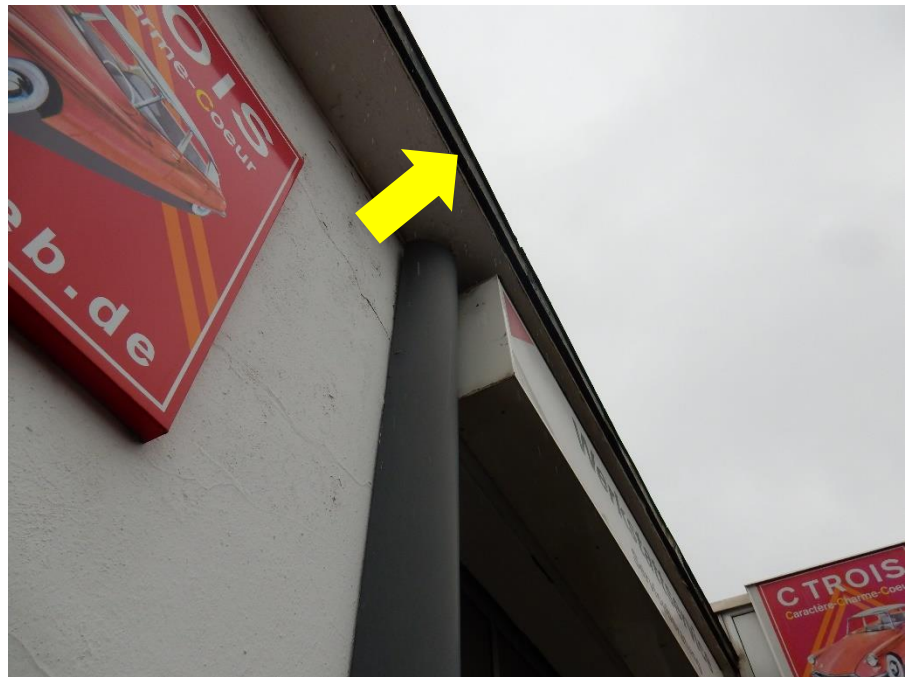
Foto 3: Entlang des Werkstatt- dachs finden sich ver- schiedene potenzielle Quartiermöglichkeiten für Fledermäuse.
