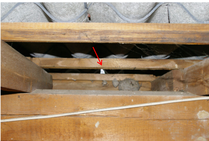
Wespennest, hier die Luftlöcher zwischen Wellzementplatten und Balken erkennbar
